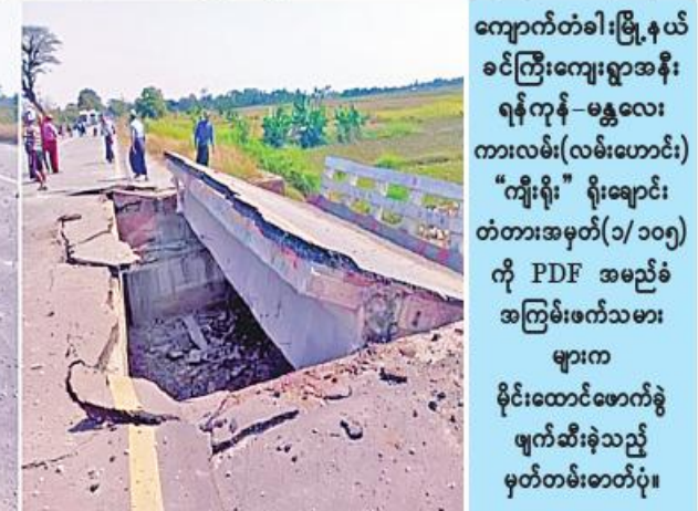
ကျောက်တံခါးမြို့နယ် ခင်ကြီးကျေးရွာအနီး ရန်ကုန်-မန္တလေး ကားလမ်း(လမ်းဟောင်း) “ကျီးရိုး” ရိုးချောင်း တံတားအမှတ်(၁/၁၀၅) ကို PDF အမည်ခံ အကြမ်းဖက်သမား များက မိုင်းထောင်ဖောက်ခွဲ ပျက်ဆီးခဲ့သည့် မှတ်တမ်းဓာတ်ပုံ။
