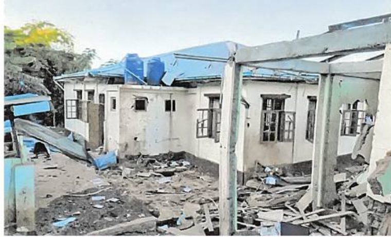
(၇-၁-၂၀၂၂)ရက်နေ့ (၁၉:၅၀)အချိန်တွင်ဖြစ်ပွားခဲ့သော ဗဟိုရုံးအဆောက်အအုံအတွင်း ပျက်စီးမှုမှတ်တမ်းဓာတ်ပုံ။
