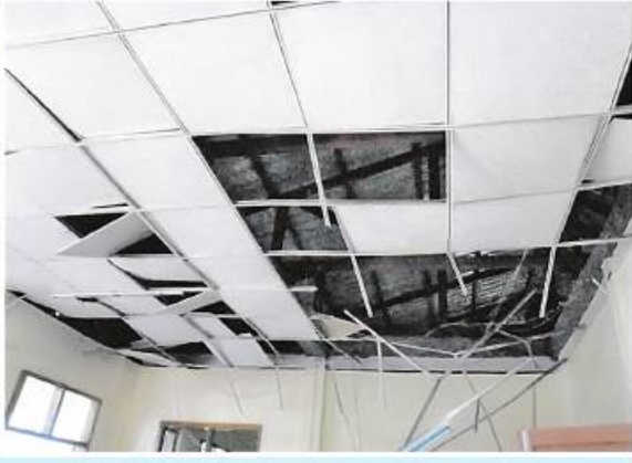
(၇-၁-၂၀၂၂)ရက်နေ့ (၁၉:၅၀)အချိန်တွင်ဖြစ်ပွားခဲ့သော ဗဟိုရုံးအဆောက်အအုံအတွင်း ပျက်စီးမှုမှတ်တမ်းဓာတ်ပုံ။
