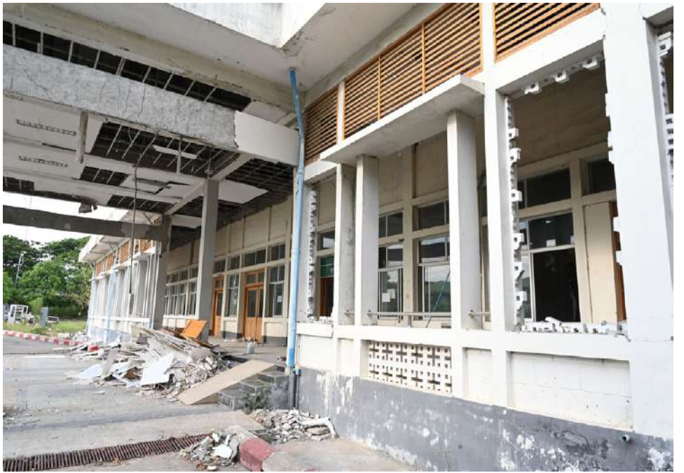
ငလျင်ဒဏ်ကြောင့် နေပြည်တော် ပြည်သူ့ဆေးရုံကြီး(ခုတင်-၃၀၀)ရှိ အဆောက်အအုံများ ထိခိုက်ပျက်စီးမှုကို တွေ့ရစဉ်။
