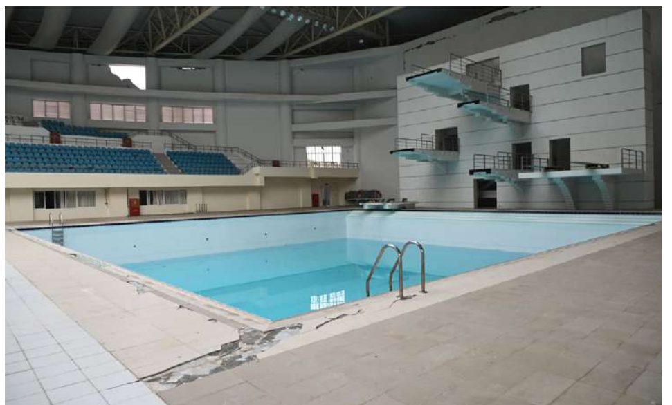
ငလျင်ဘေးဒဏ်ကြောင့် ဝဏ္ဏသိဒ္ဓိရေကူးကန် ထိခိုက်ပျက်စီးမှုကို တွေ့ရစဉ်။
