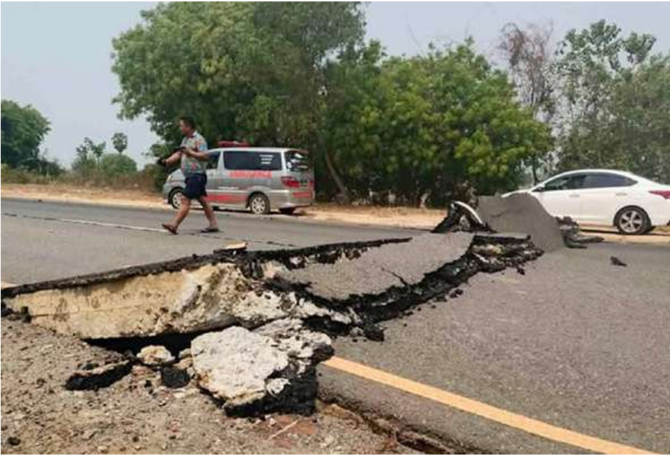
လျင်ဒဏ်ကြောင့် ရန်ကုန်-မန္တလေးအမြန်လမ်းမကြီးတစ်နေရာ အက်ကွဲနေမှုကို တွေ့ရစဉ်။
