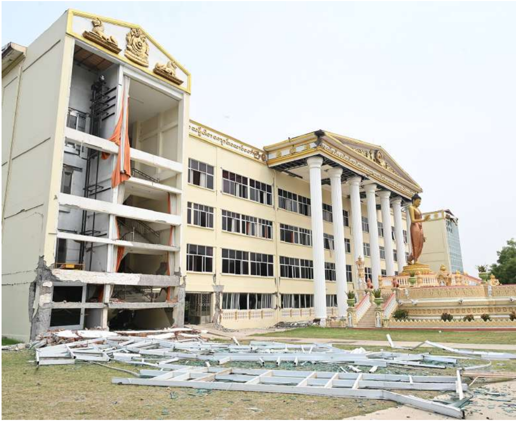
ငလျင်ဘေးဒဏ်ကြောင့် သီတဂူသံဃာသင်္ဃာတကျောင်းဆောင်တော်ကြီး ထိခိုက်ပျက်စီးခဲ့မှုအား တွေ့ရစဉ်။
