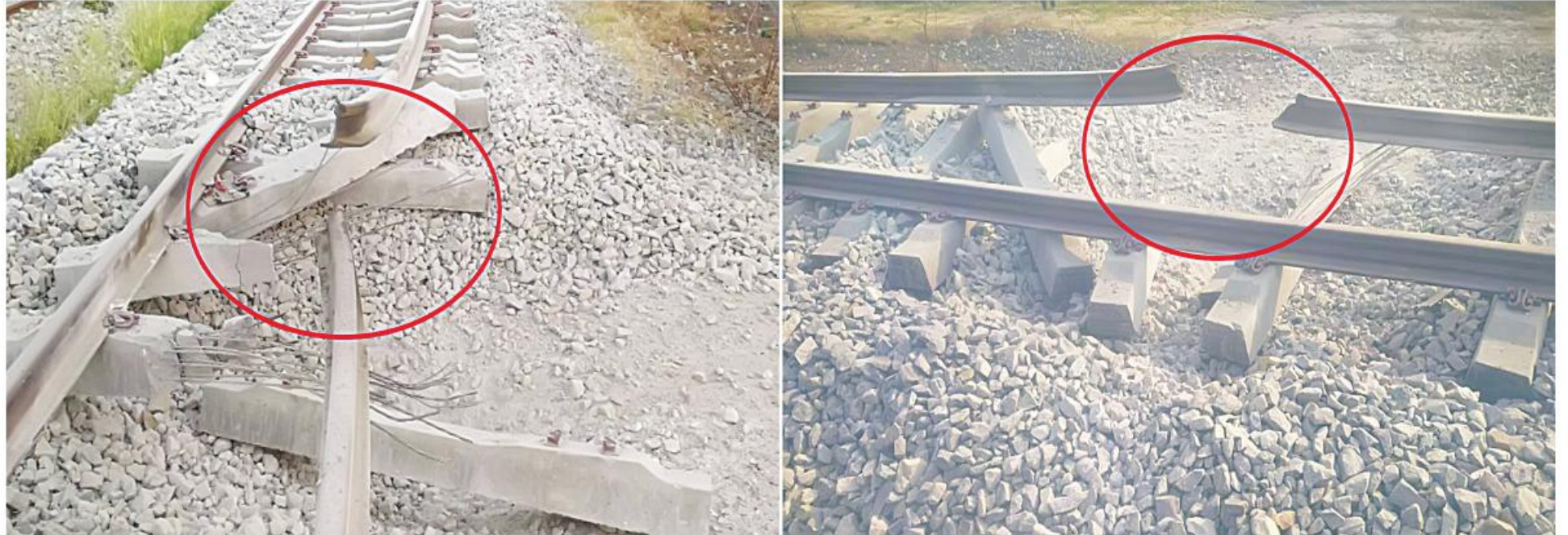
အကြမ်းဖက်သောင်းကျန်းသူများ၏ မိုင်းဖောက်ခွဲဖျက်ကြောင့် ကျောက်တံခါးမြို့နယ် တောကျွဲအင်းနှင့် ကညွတ်ကွင်းဘူတာအကြား ရထားလမ်းမိုင်တိုင် ၁၂၀/၂-၃ ကြား ပျက်စီးဆုံးရှုံးမှု မှတ်တမ်းဓာတ်ပုံ။
