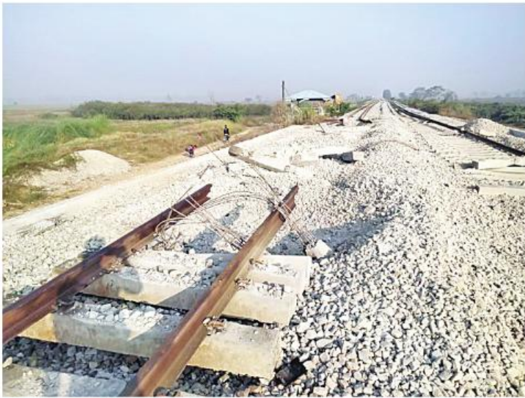
မိုင်းဖောက်ခွဲခံရမှုကြောင့် ရန်ကုန်-မန္တလေးရထားလမ်းပိုင်း ပိန်းစလုပ်နှင့်ကျောက်တံစားဘူတာအကြား တံတားအမှတ်(၁၄၅)ပေါ်တွင် ရထားလမ်းပျက်စီးဆုံးရှုံးမှုကို တွေ့ရစဉ်။
