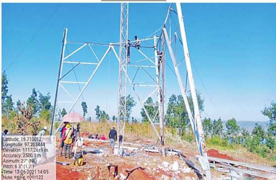
၁၈-၁၁-၂၀၂၁ ရက်တွင် ပြုလုပ်ပျက်စီးခဲ့သည့် ကေစီ ၂၃၀ ဘီလူးချောင်း(၂)-ရွှေမြို့ဓာတ်အားလိုင်း တာဝါတိုင်အမှတ်(၁၂၂)ကို ပြန်လည်ပြုပြင်နေသည့် မှတ်တမ်းဓာတ်ပုံ။
