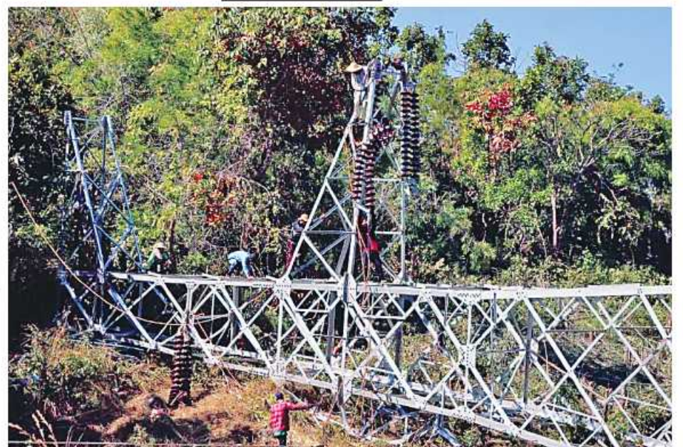
၂၁-၁၂-၂၀၂၁ ရက်တွင် ပြုလုပ်ပျက်စီးခဲ့သည့် ကေစီ ၂၃၀ ဘီလူးချောင်း(၂)-ရွှေမြို့ဓာတ်အားလိုင်း တာဝါတိုင်အမှတ်(၁၅၃)ကို ပြန်လည်ပြုပြင်နေသည့် မှတ်တမ်းဓာတ်ပုံ။
