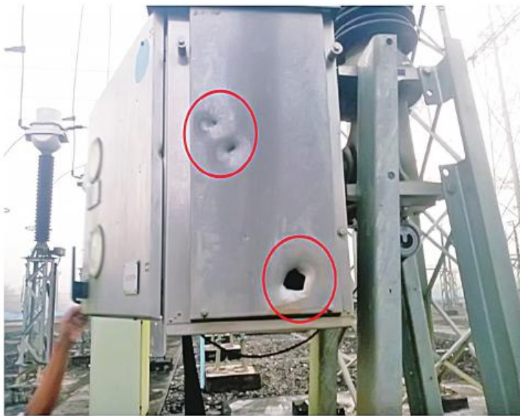
50 MVA Generator Circuit Breaker ပျက်စီးမှုမှတ်တမ်းဓာတ်ပုံ။
