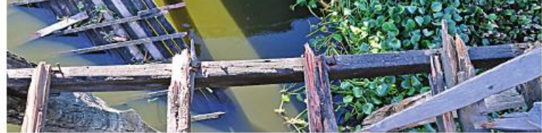
ဦးပိန်တံတား လူစည်ကား၍ အရှေ့ဘက်ခြမ်းတံတားကျိုးကျမှုကို တွေ့ရစဉ်။
