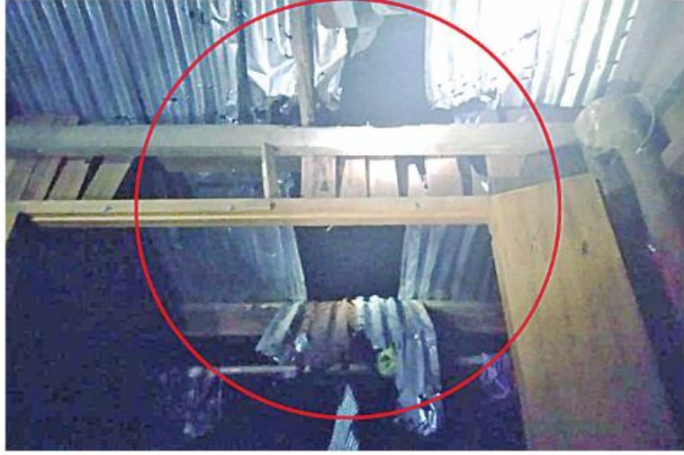
လက်နက်ကြီးကျည် ကျရောက်ပေါက်ကွဲမှုကြောင့် နေအိမ်ထိခိုက်ပျက်စီးမှု မုတ်တမ်းဓာတ်ပုံ။
