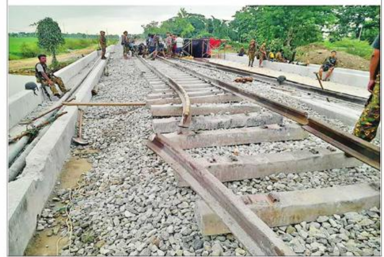
၁၈.၇.၂၀၂၃ ရက်နေ့က အကြမ်းဖက်သောင်းကျန်းမှုများ၏ ရက်စက်ကြမ်းကြုတ်စွာ မိုင်းခွဲဖျက်ဆီးမှုကြောင့် ရန်ကုန်-မန္တလေးရထားလမ်းအဆင့်မြှင့်တင်ရေးစီမံကိန်း၏ ဆောင်ရွက်ပြီးစီးနေသည့် ရထားလမ်းထိခိုက်ပျက်စီးမှုအခြေအနေ
