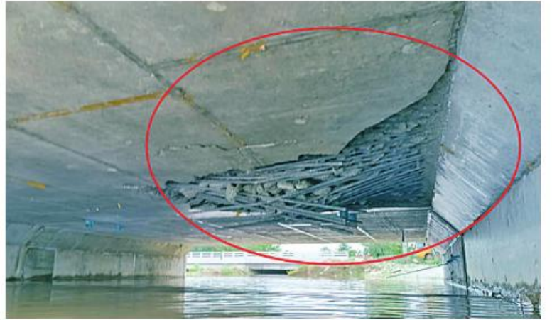
ရထားလမ်းတံတားအမှတ် ၁၆၁ ၏ ကွန်ကရစ်ကြမ်းစင်း Slap အောက်ခံမျက်နှာပြင် ကွာကျထိခိုက်ပျက်စီးမှု အခြေအနေကို တွေ့ရစဉ်။
