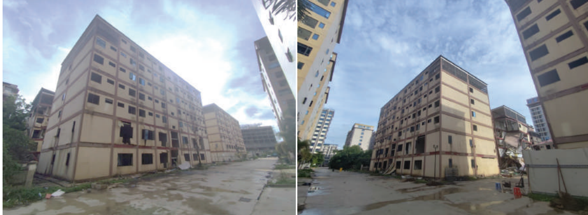
ကရင်ပြည်နယ် မြဝတီခရိုင် ရွှေကုက္ကိုလ်နယ်မြေရှိ အွန်လိုင်းလိမ်လည်လောင်းကစားမှုလုပ်ကိုင်ခဲ့သည့် တရားမဝင် ခုနစ်ထပ် လူနေအဆောက်အအုံ မဖြိုဖျက်မီ တွေ့ရစဉ်။
